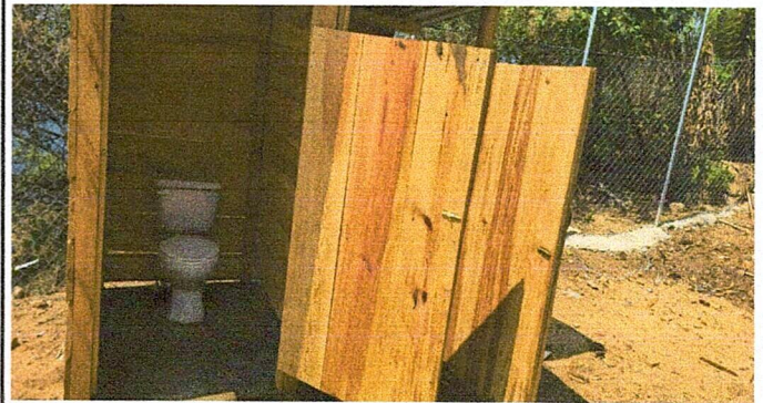
Foto 2: AHORA CONTAMOS CON SANITARIOS LAVABLES
